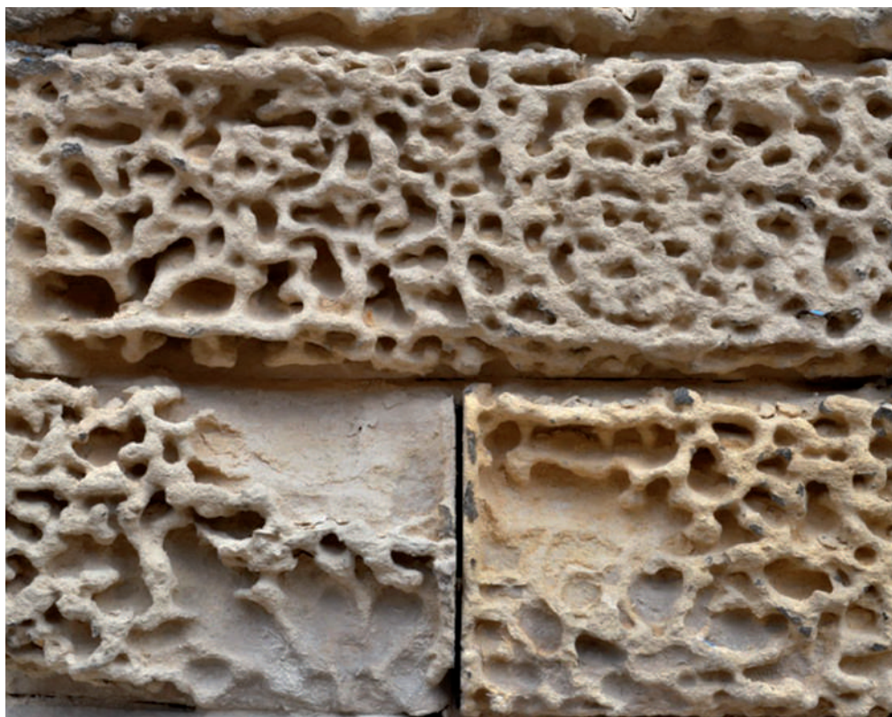
Βαθιά κυψελιδική διάβρωση σε επιφάνεια τοιχοποιίας.
