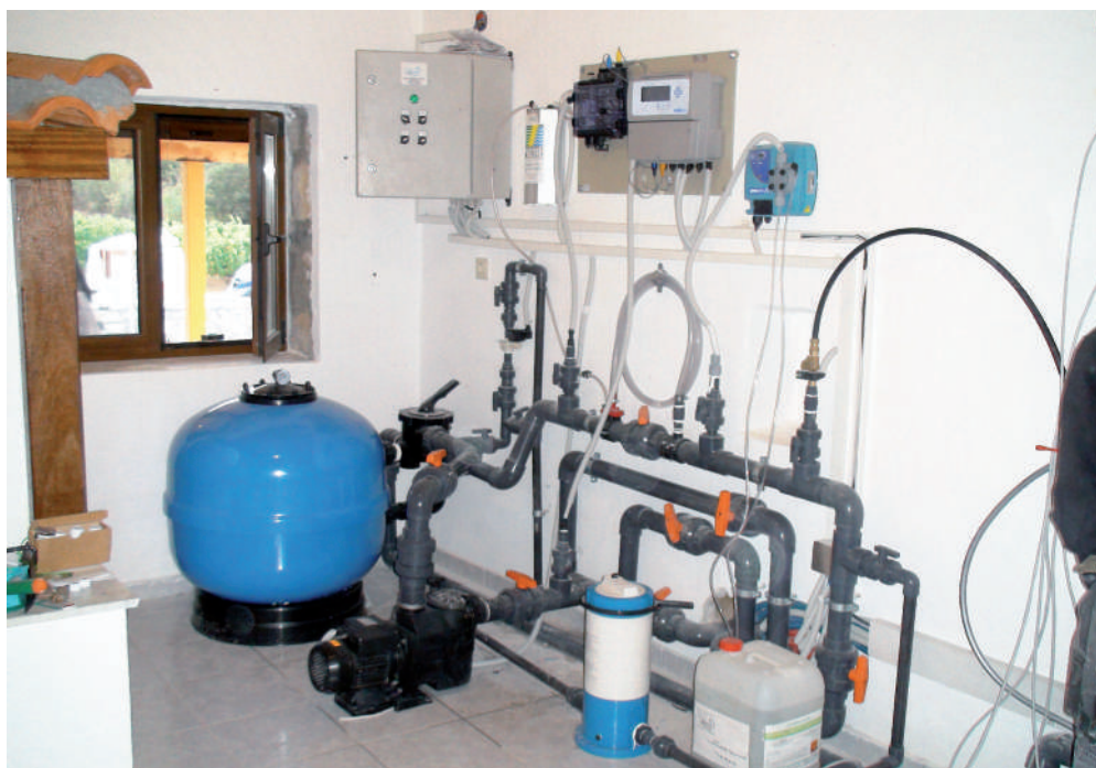
Δωμάτιο επεξεργασίας νερού. Απεικονίζεται το φίλτρο άμμου, η αντλία ανακυκλοφορίας, η δοσομετρική αντλία απολυμαντικού μέσου, το δίκτυο σωληνώσεων και ο πίνακας ελέγχου της μονάδας.
