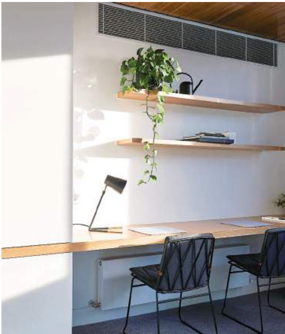
Εγκατάσταση εσωτερικής μονάδας αντλίας θερμότητας με στόμια μικρής διατομής σε περιπτώσεις περιορισμένου χώρου.
