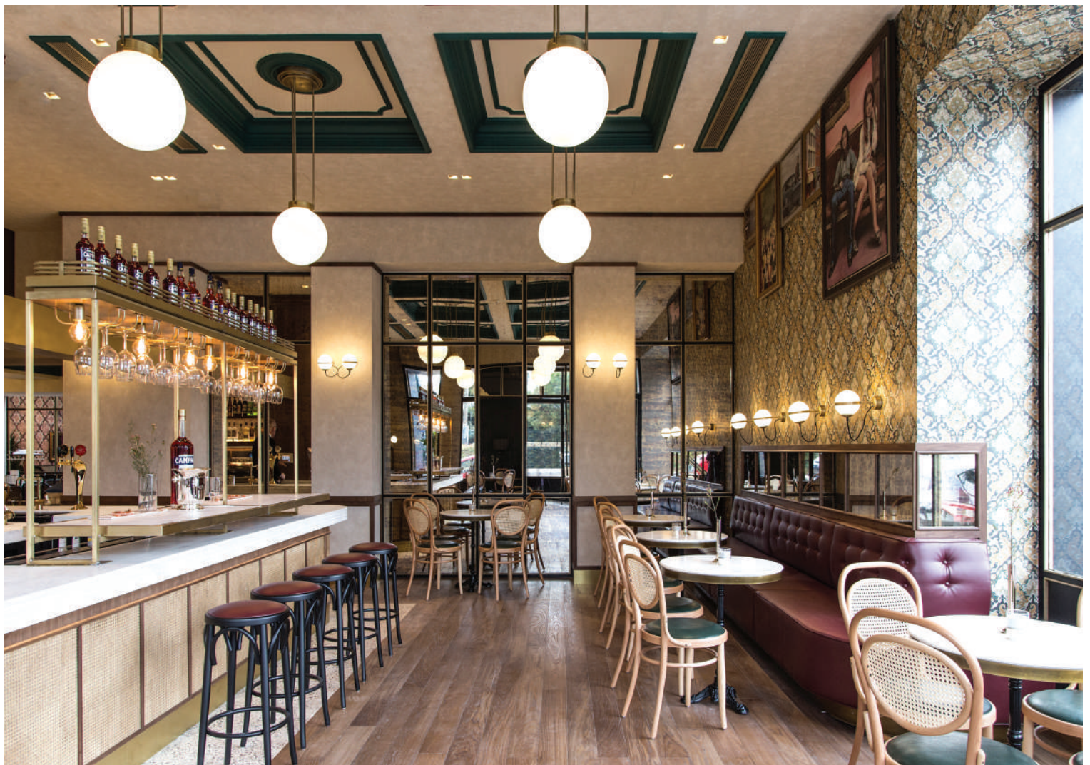
Στο σαλόνι εστίασης τα στόμια προσαγωγής αέρα τοποθετούνται γραμμικά στην οροφή και γίνονται μέρος του διάκοσμου. Αρχιτεκτονική μελέτη: Minas Kosmidis. © Ioanna Roufourolou.
