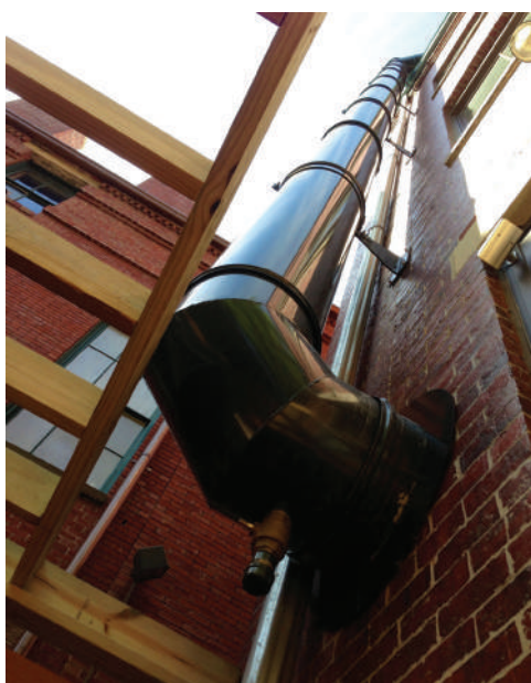
Η απόρριψη του αέρα στον εξωτερικό χώρο πρέπει να γίνεται, χωρίς να δημιουργείται μόλυνση στο περιβάλλον ή όχληση στους γύρω κατοίκους.
