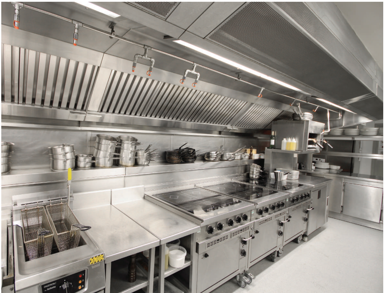
Επάνω από το χώρο των μαγειρικών συσκευών, τοποθετείται χοάνη, το περιτύπωμα της οποίας εξέχει των μαγειρικών συσκευών, ώστε να μην επιτρέπει τη διαφυγή καπναερίων και οσμών εντός της κουζίνας.
