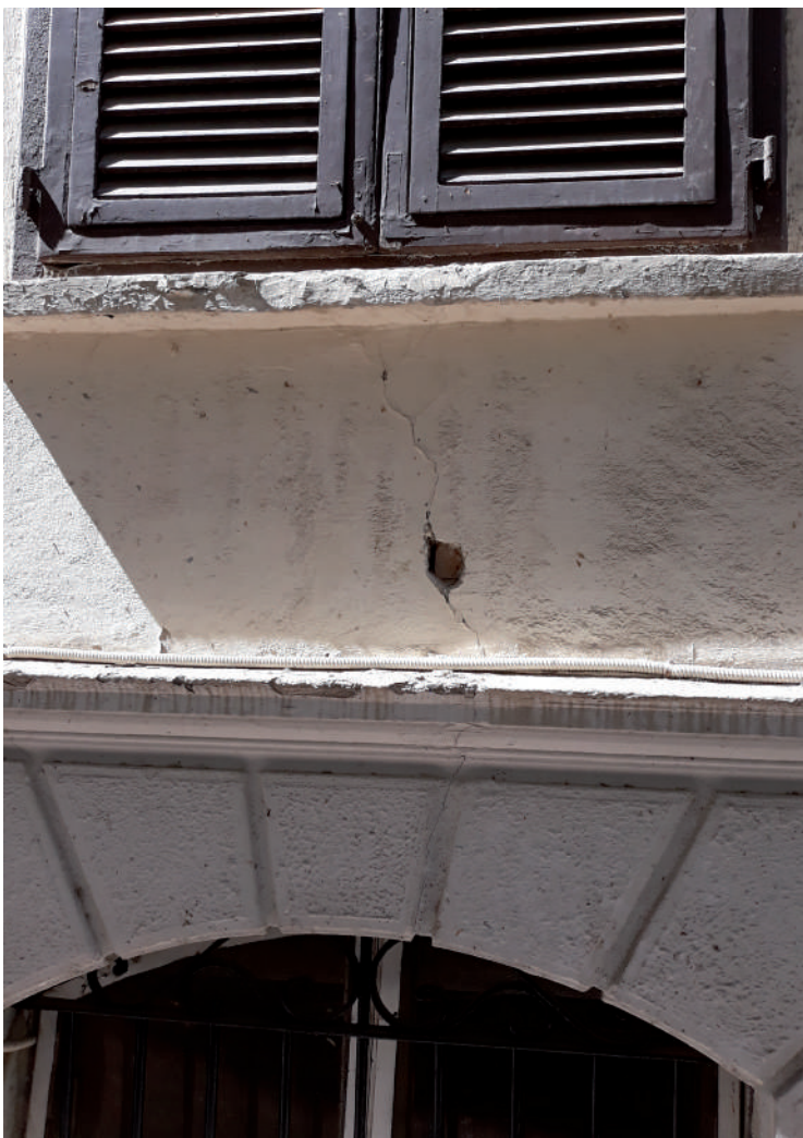
Ξεφλουδίσματα και απώλεια επιχρισμάτων.
