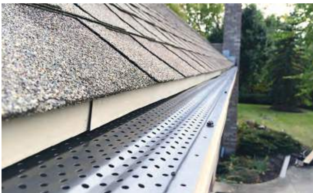
Συνιστάται η τοποθέτηση ειδικής σχάρας για την προστασία της υδρορροής.
