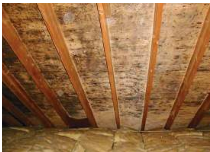
Η συμπύκνωση υδρατμών και η δημιουργία μούχλας στο πέτωμα της στέγης, επάνω από θερμομονωμένο κατάστρωμα, είναι συνήθης όταν δεν έχει προβλεφθεί φράγμα υδρατμών κάτω από τη θερμομονωτική στρώση και επαρκής αερισμός.
