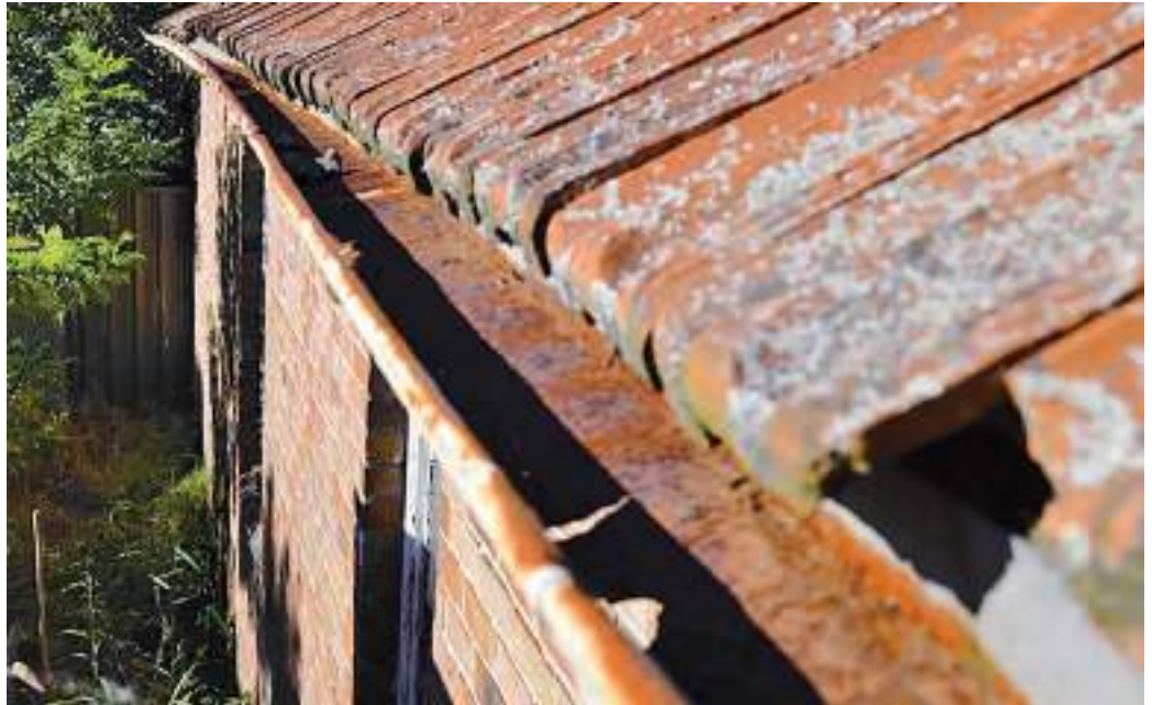
Μη συντηρημένη στέγη. Έντονη διάβρωση στα κανάλια υδρορροών και ανάπτυξη βρύων και λειχηνών στα κεραμίδια.
