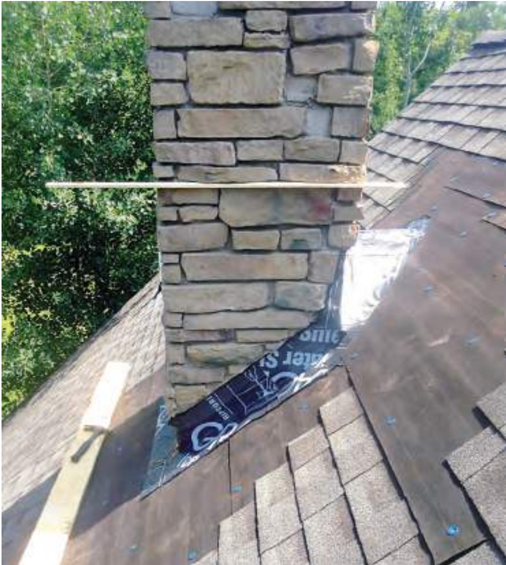
Τοποθέτηση στεγανοποιητικής μεμβράνης περιμετρικά της καμινάδας σε υφιστάμενη στέγη. Γίνεται απομάκρυνση των ασφαλικών κεραμιδιών, ακολουθεί η επικόλληση της μεμβράνης και, τέλος, επανατοποθετούνται τα υλικά επίστρωσης.
