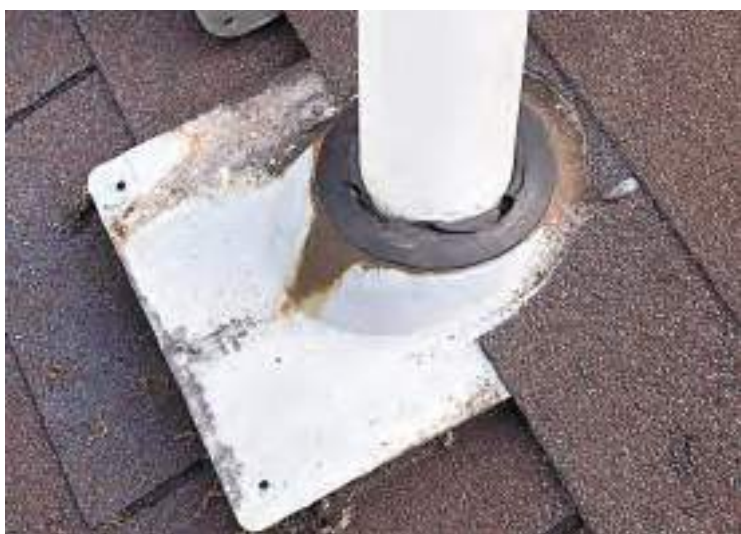
Διάβρωση προστατευτικής μεταλλικής διατομής.
