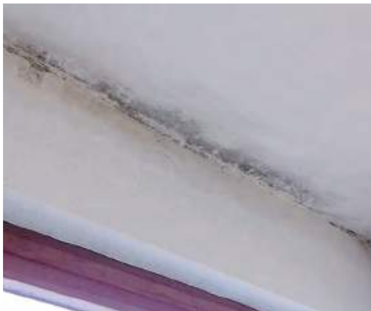
Η ανάπτυξη μούχλας στα σημεία επαφής της οροφής με κατακόρυφα στοιχεία οφείλεται στη συμπύκνωση υδρατμών (θέσεις θερμογεφυρών).
